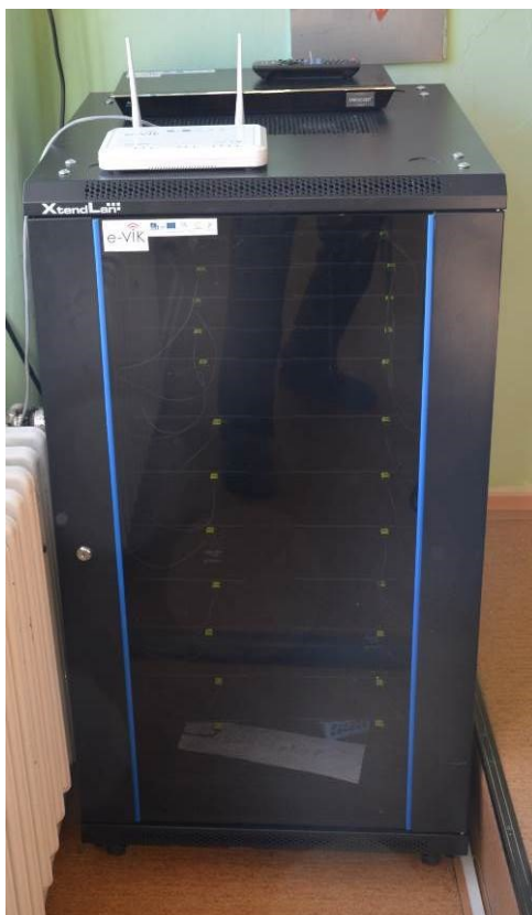
Obr. 14: Skříň na nabíjení tabletů. Běžně se tato skříň používá na switche
